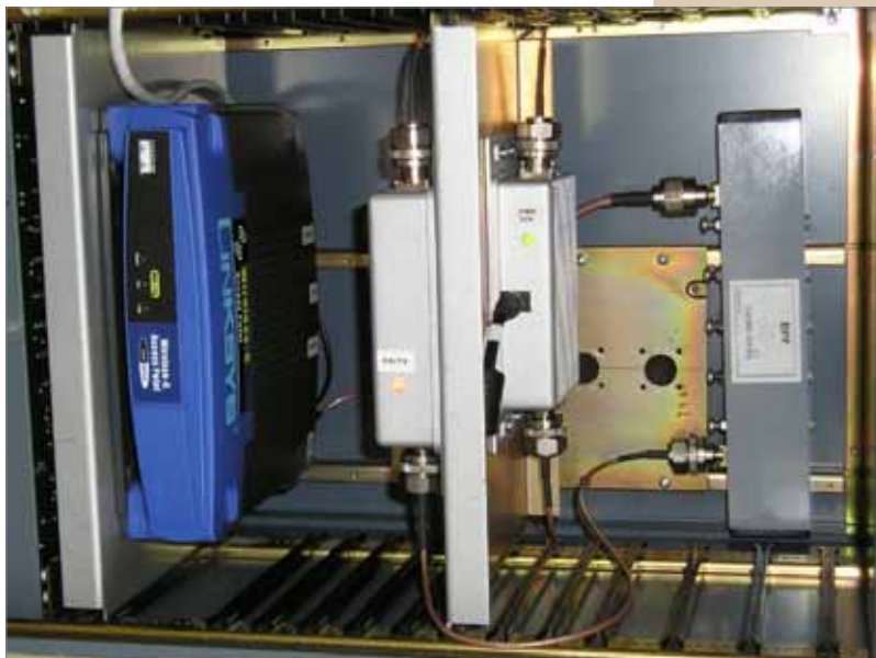
Slika 11 - WLAN oprema vgrajena v 19" ohišje
