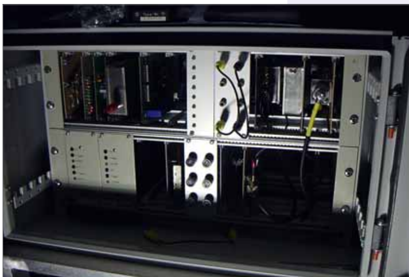
Slika / Bild 6 - Hauptgerät untere Reihe Netzgeräte und Kommandoempfänger 70cm, oben Steuerung, OSD und Sender
